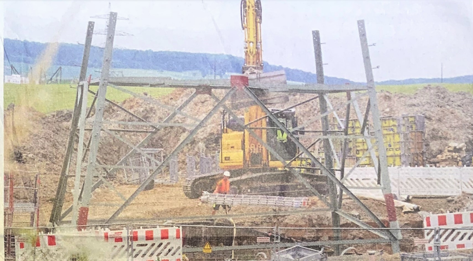
Zwischen dem Abzweig zur Bundesstraße 243 und Bültum laufen die Arbeiten an den Masten auf Hochturen.
